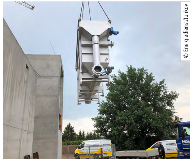
Abb. 4: Lieferung der beiden Wärmetauscher. Links der Anbau des neuen Rathauses mit der Heizzentrale des Kalten Nahwärmenetzes. Hier begegnen sich der warme Primärkreislauf mit Abwasser und der kältere Sekundärkreislauf des Wärmenetzes.
