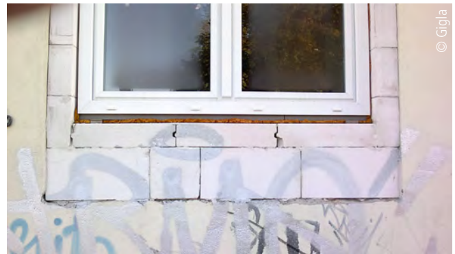
Abb. 3: Neues Fenster mit nachträglicher Aufmauerung. Am Blendrahmen-Unterstück sind in der Fugenabdichtung mit Polyurethan(PUR)Spritzschaum die Tragklötze zu erkennen. Die Abbildung verdeutlicht mögliche Schwachstellen beim Zusammenfügen der Systeme »Fenster« und »Außenwand«.
