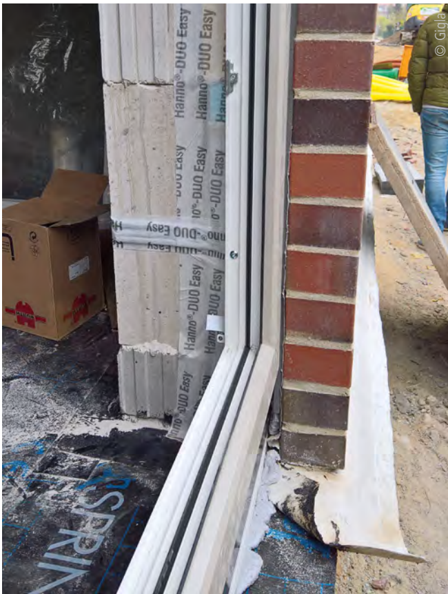
Abb. 2: Sachgerechter Einbau eines Blendrahmens in einer Außenwand aus Verblendmauerwerk. Der Einbau erfolgt in der Dämmebene an der Tragschale aus Kalksandstein-Planelementen. Die Befestigungspunkte und die innen- und außenseitige Abdichtung sind zu erkennen.
