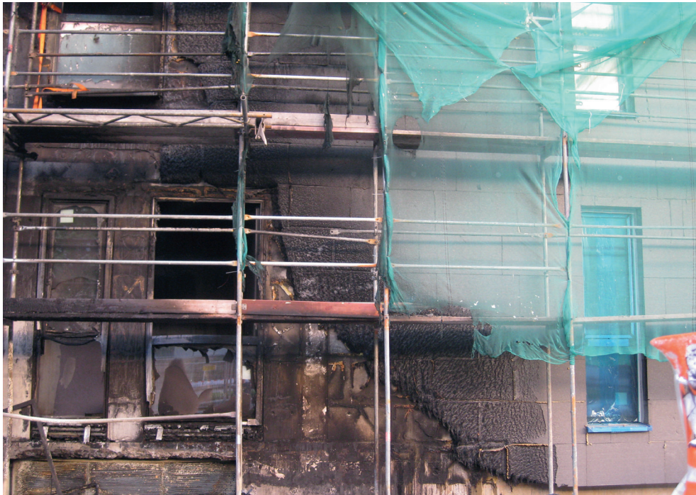
(2) Zerstörtes WDVS: Nach dem Fassadenbrand auf Frankfurter Baustelle
